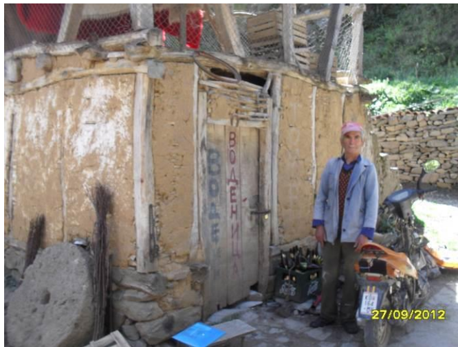
Фотографија бр. 13. Предна и бочна страна на воденица со отворена катна дрвена конструкција и покрив на две води, покриен со поцинкован лим, с. Станци
